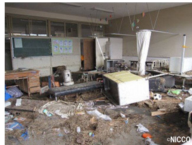
▲ 被害を受けた小友小学校、備品が散乱する保健室内部
