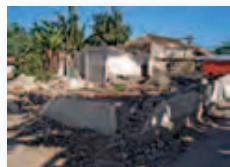
地震により破壊した家 ©ICA/JPF
