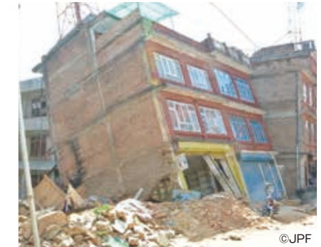
倒壊した家屋
