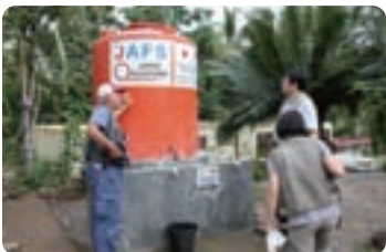
緊急支援 ① JAFSにより設置された給水施設を視察するスタッフと外部専門家 ©JPF
