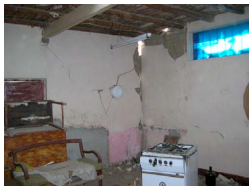
損壊した家屋内部
