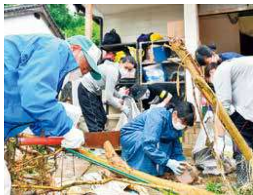
豪雨で被災した民家で流木を切ったり、災害ごみを運び出したりするボランティアら =2020年7月
