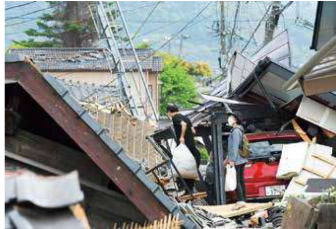
倒壊した住宅のがれきりで埋め尽くされた道路=2016年4月20日、益城町
