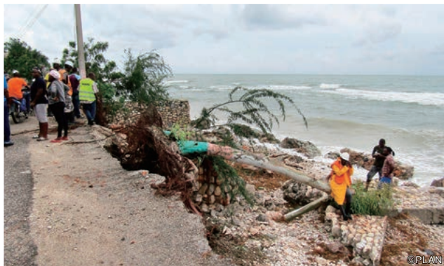
ハリケーンによって破壊された護岸
