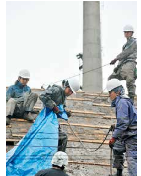
地震で破損した屋根瓦を撤去し、ブルーシートをかぶせるボランティア =2016年4月25日
