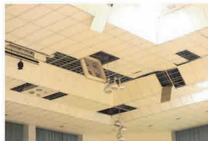
天井が落下しそうなスポーツセンター
