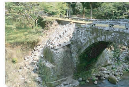
崩れた八勢目鑑橋
