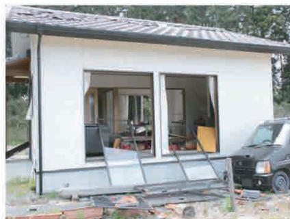
被害を受けた田代地区の干無田公民館
